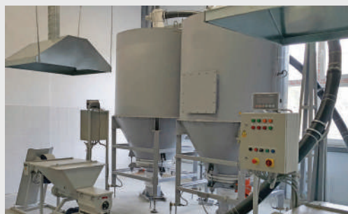
Линия бестарного хранения муки на основе гибких шнеков
