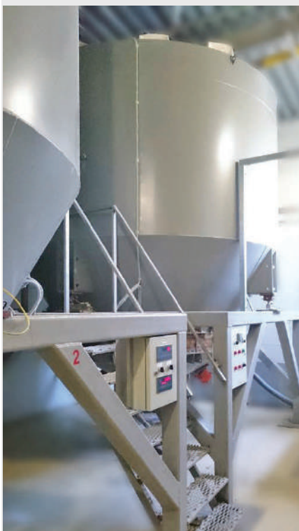
Пульт управления бункерами с весовыми индикаторами и транспортными системами
